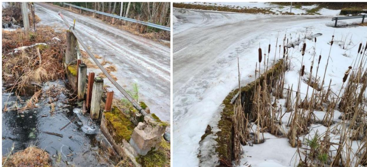
Figur 12. Vänster: igensatt sättutskov nära de aktiva vattentrummorna. Höger: igensatt intag till sågverk.
